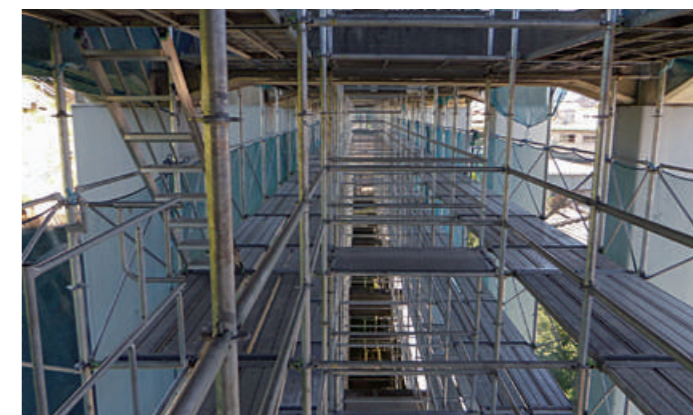
新幹線高架下の点検用通路 横断方向の中間梁があっても回避して設置可能 手摺付きの昇降階段・左右間の渡り通路も自在に設置
