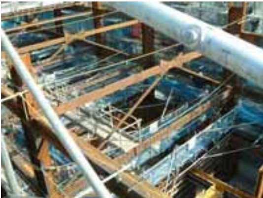
【設置写真(上から)】 現場: 明神台(馬淵建設様) 2005年3月
